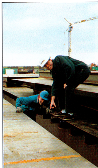
Betongplattorna som är upp till 22 x 24 meter stora och 1,25 meter tjocka lyfts ur formarna med specialdomkrafter som går på räls under formarna.
