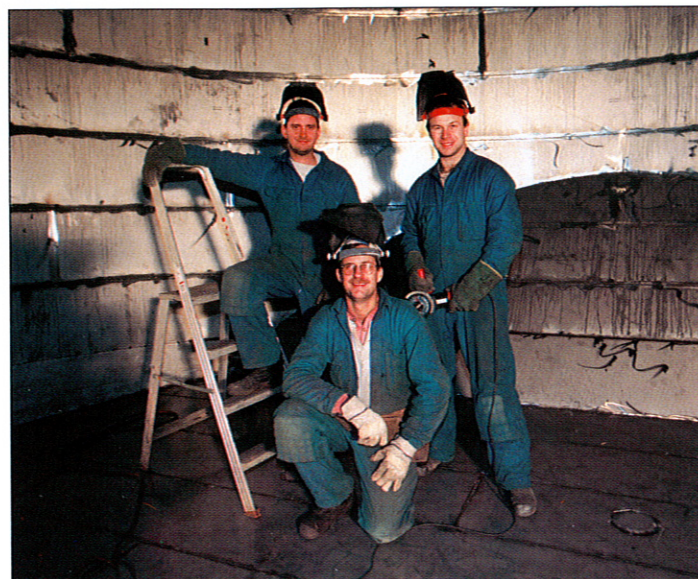
Lining av cisterner innebär att man gör en invändig beklädnad av en befintlig cistern. Här är tre glada montörer från Stål & Rörmontage i en cistern på Mörrums Bruk. Stående fr v, Torbjörn Lundström, Magnus Andersson. Framför dem sitter montageledaren Göran Carlson.
